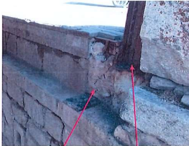
Dégradation du massif béton
